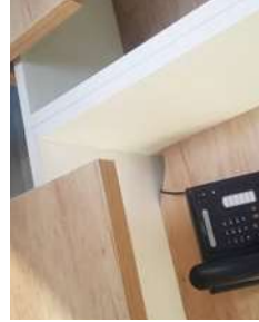
Circulation des câbles
